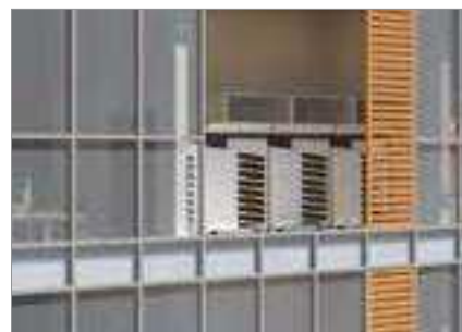
L'unité extérieure est dissimulée à l'intérieur du bâtiment sans affecter l'image globale de celui-ci
